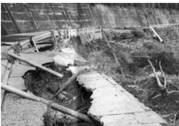
長良川の大洪水による美並町内道路災害状況
